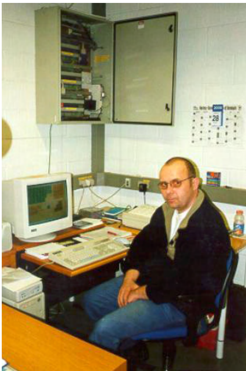
På Flådestation Korsør står maskinarbejder Knud-Henrik B. Elholm fra Driftssektionen for den daglige styring af CTS-anlægget.
