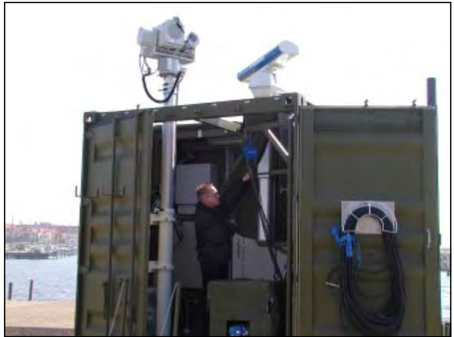
Den første container er nu færdig, projektleder, Værkfører Jack R. Jæger, „justerer” på resultatet.
