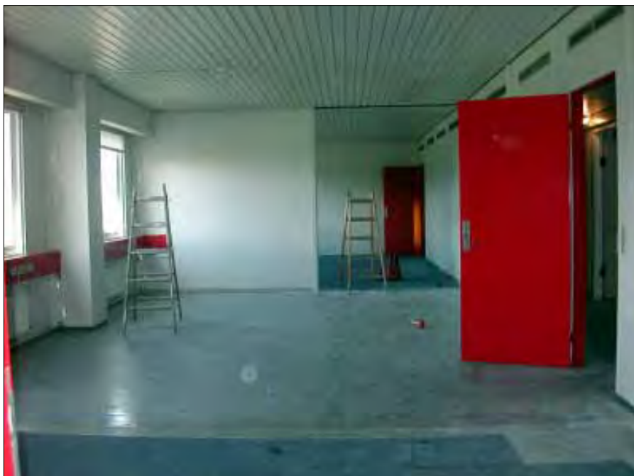
De nuværende små kontorer ændres til store kontorer med halve vægge som opdeling.
