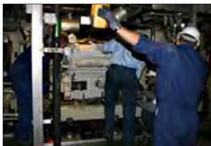
Det ses tydeligt, hvor trang pladsen er i maskinrummet.
