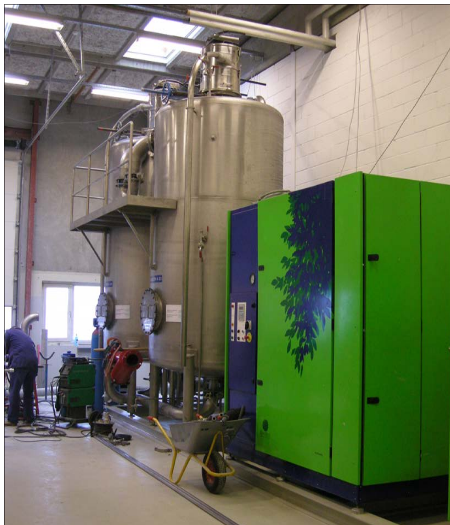
Inddamper og kulfilter til spildevandsbehandling.
