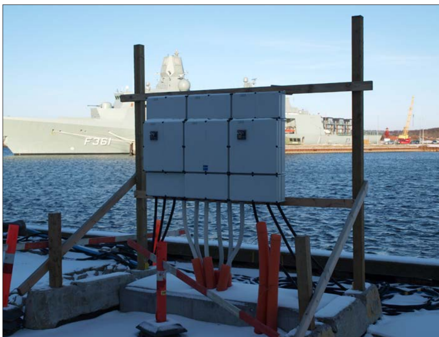
Midlertidig strømforsyning ved "Alcatelkajen". Den er nu erstattet af et permanent strømskab.
