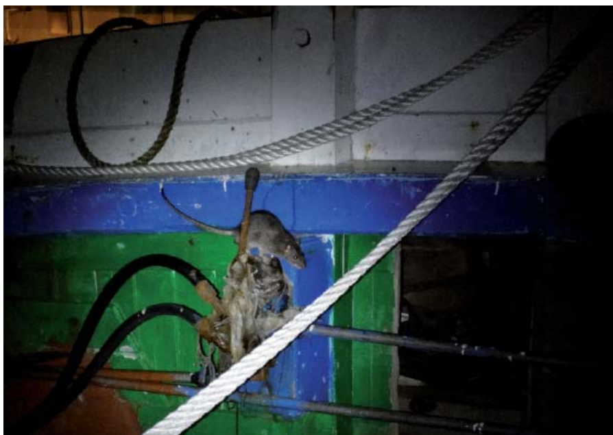
Som det fremgår af billedet, var rotterne et problem
