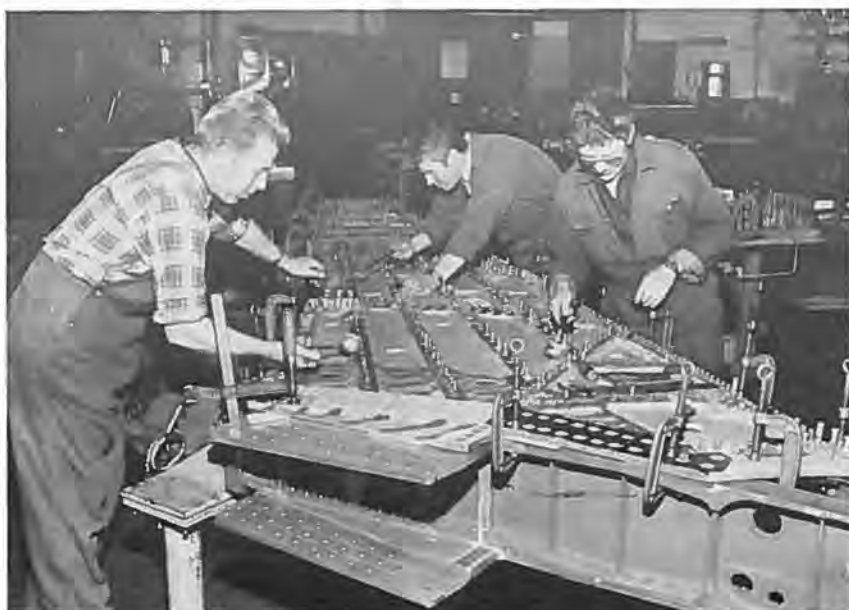
Her ses det komplicerede arbejde med at overføre det gamle panels lidt individuelt borede huller til det nye.
