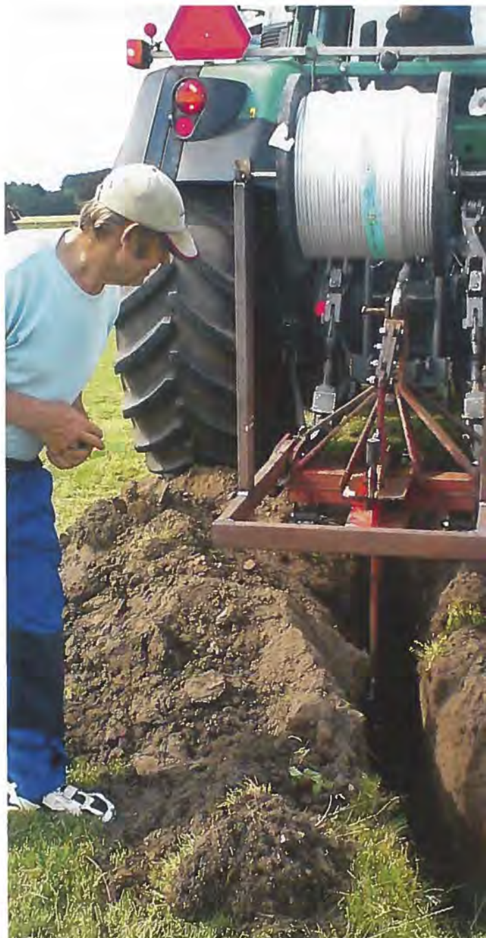
Der er lys forude! Kreative hoveder har konstrueret en snedig kabelplov for at lette nedlægningen af de lange kabler til lysanlægget på EKRS.
