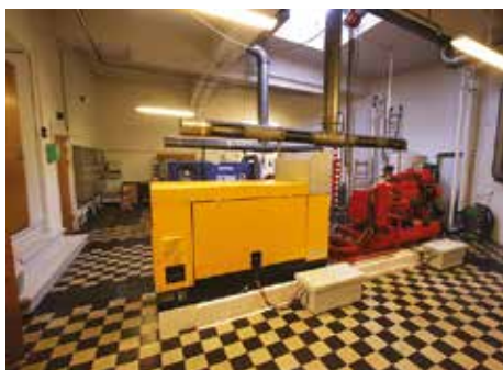
På maskincentralen er der fire diesel-agregater der sørger for, at fyr og al elektronisk udrustning konstant kan være i drift. (Tom Wismann)
