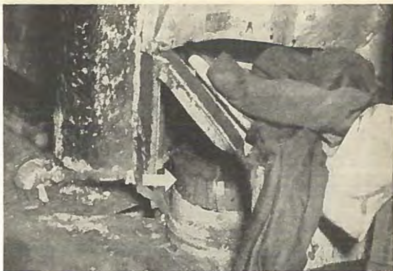
Fig. 2. Ventilationskanaler er farlige vandindtrængningsveje. Bemærk — ved pil — hvorledes man har tilproppet en sådan kanal.
