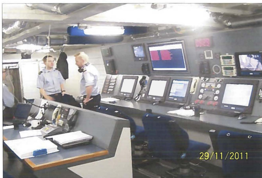
Fregattens maskinkontrolrum. Herfra overvåges og styres skibets tekniske installationer; maskiner; generatorer; aircondition og meget, meget mere. Tavlen midtfor med de røde bogstaver er det centrale oversigtsbillede for havaritjenesten. (Foto forfatteren)
