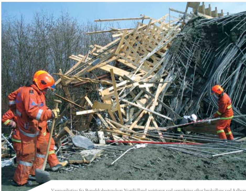
Værnepligtige fra Beredskabsstyrelsen Nordjylland assisterer ved oprydning efter brokollaps ved Aalborg
