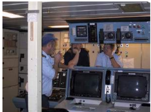
Møde i kontrolrummet: Teknikofficeren, Vedligeholdelsesofficeren og Burmanden Jon.
